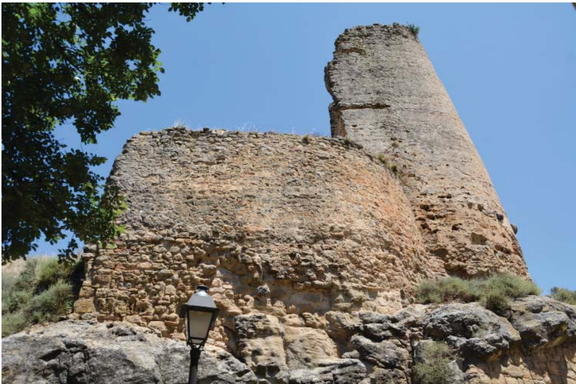
Fig. 9. Façana oest de la torre i d'un tram de muralla, el més ben conservat. APP, 2020.
