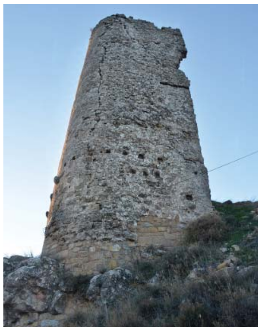
Fig. 10. Costat sud-est del folre exterior, on, a banda de les esquerdes i de la reparació inferior, s'observen les dues fileres d'encaixos i, a la part alta l'encaix d'un tauló de fusta. Foto: APP, nov 2017.
