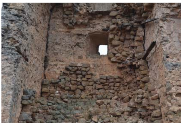
Fig. 23. Vista frontal de l'interior de la torre. On s'observa que la fàbrica de la interior es troba descarnada i tan sols s'aguanta gràcies a les fustes. És de la part esquerra que es van produir els esfondraments. APP, gener de 2018.
