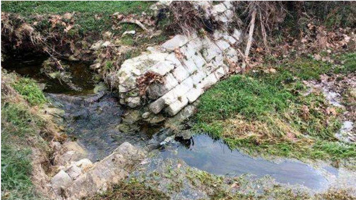
Imatge de la resclosa que les obres han deixat al descobert AJ. SOLSONA
