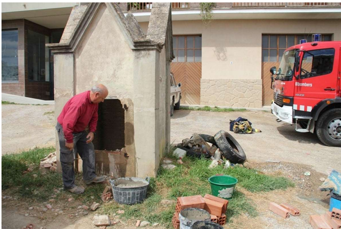
La Brigada Municipal ha tapat el forat per on han passat els bombers per accedir al pou. A la dreta hi veiem la brossa retirada que surava damunt l'aigua del pou
