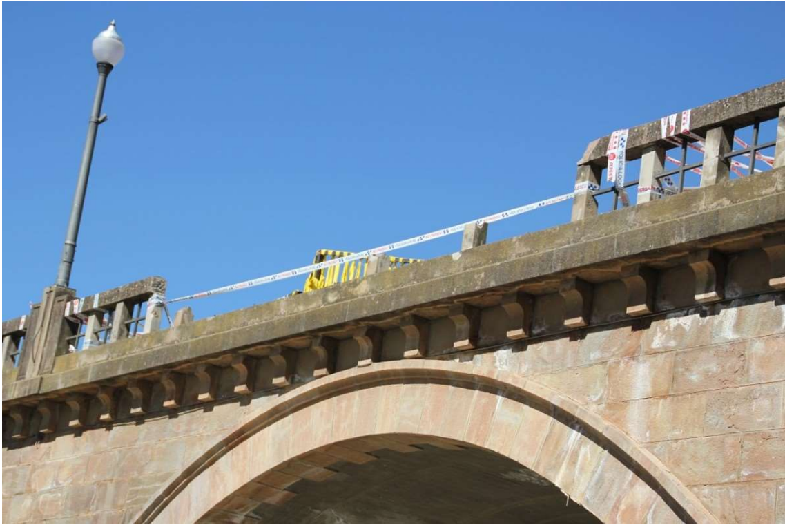
Estat en que ha quedat la barana | Ramon Estany
