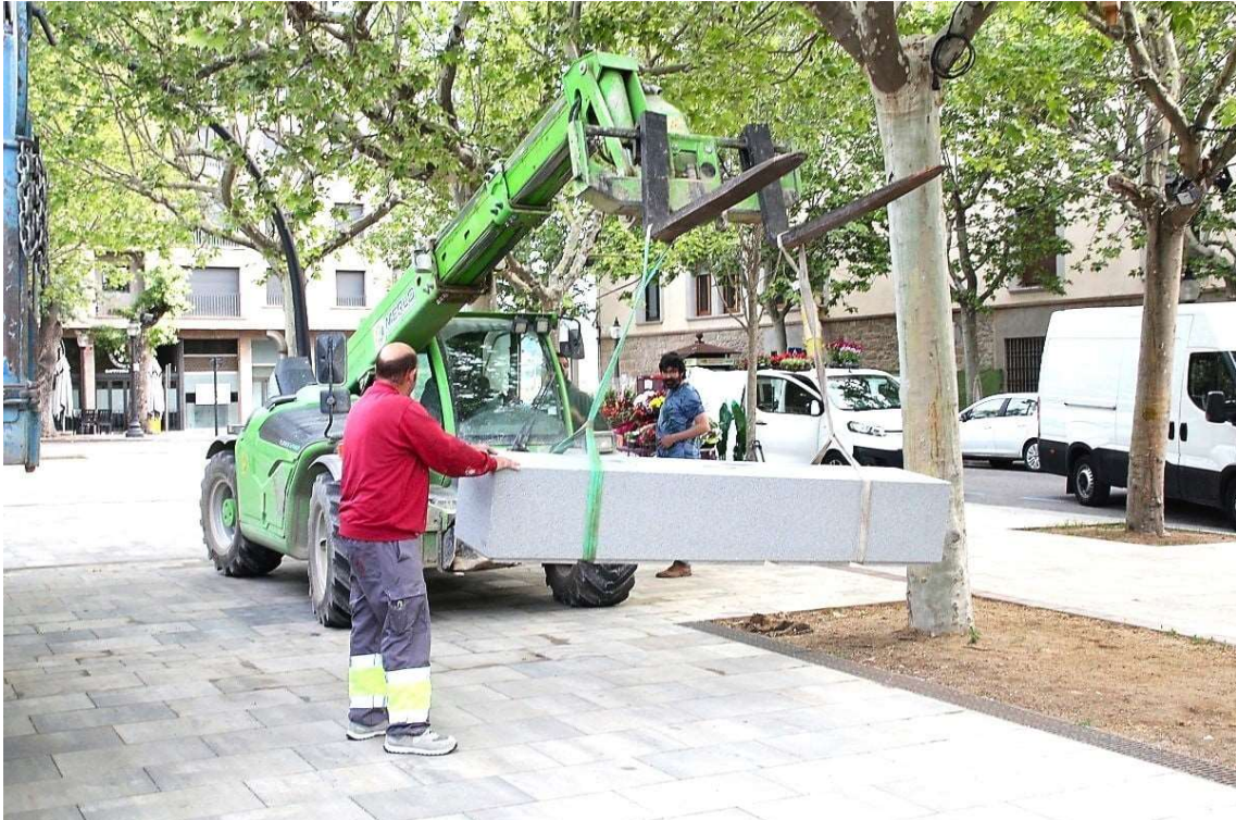
Una grua diposita a la Plaça del Camp un dels bancs de formigó | Ramon Estany
