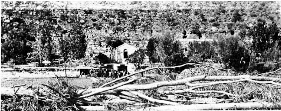
EL CANAL D'URGELL A PONS. VISTA DE L'ENTRADA OBSTRUÏDA Y TAPADA PER MES DE DOS METRES DE TERRA, ARBRES Y BROSTA — (Fots. de Claverol.)
